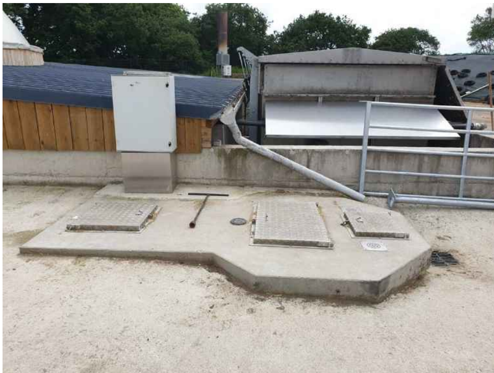
Vue du bassin de confinement avec poste de relevage équipé d'une sonde
