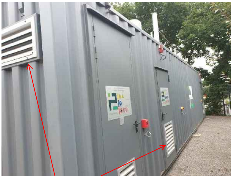
Ventilation haute et basse local épuration
